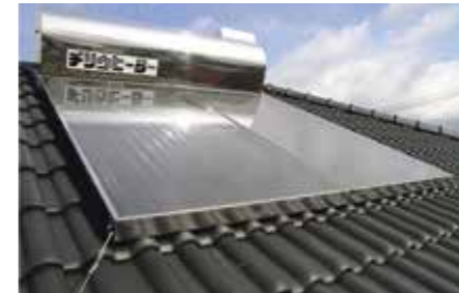
住宅の屋根に設置された太陽熱温水器。 写真提供：チリウヒーター株式会社
