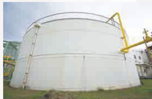
佐賀市下水浄化センターの消化槽。下水処理でつかった汚泥を発酵させてガス発電と堆肥づくりに役立っている。
