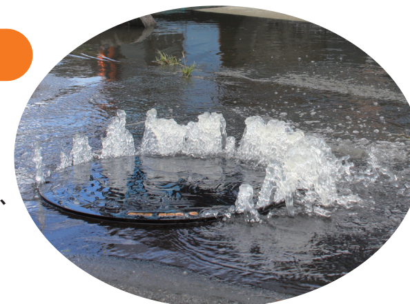
局地的大雨のときは、マンホールから水がはげしくふき出すこともある。
