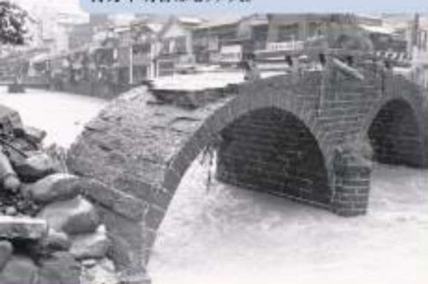
橋の半分がこわれた重要文化財の眼鏡橋 (提供：共同通信社)
