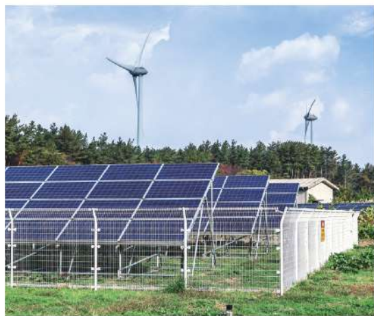
太陽光発電と風力発電の設備。
